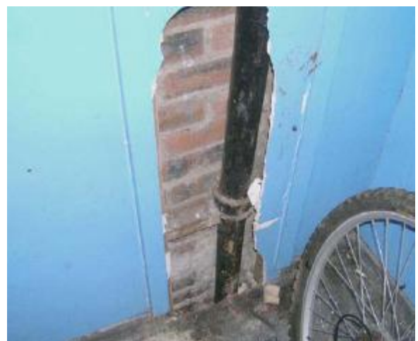
Figura 14 – Painel de isolamento contendo amianto
