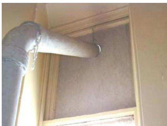
Figura 6 – Conduta em fibrocimento com selantes de junta em cordão de amianto. A conduta atravessa um painel também com amianto
