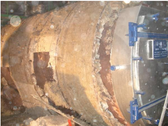
Figura 15 – Isolamento térmico de caldeira
