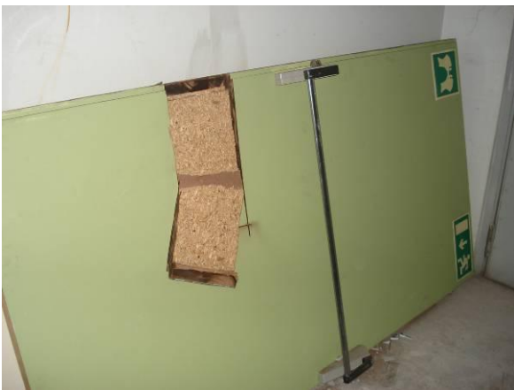
Figura 16 – Interior de porta corta-fogo
