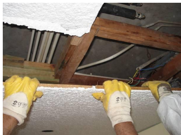
Figura 19 – Placas de tecto falso
