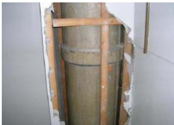
Figura 5 – Caixa de painéis de isolamento e tubagem de fibrocimento
